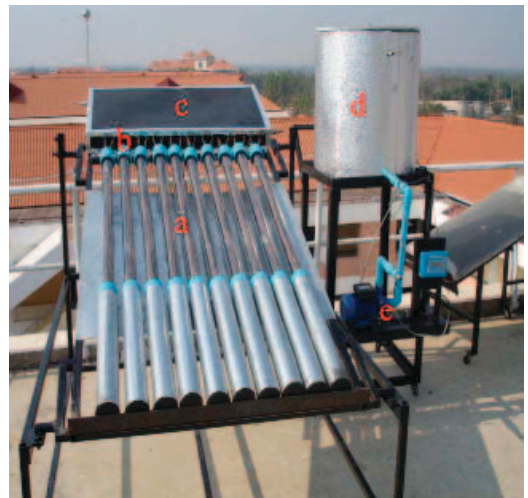
รูปที่ 15 ชุดแผงรับพลังงานแสงอาทิตย์แบบท่อความร้อนชนิดส้นวงรอบที่ติดตั้งวาล์วก้นกลับ โดยท่อความร้อน โดย (a)CLOHP/CV Circular Tube Solar Collector; (b) Adiabatic Gap; (c) Condenser Water Tank; (d) Water Storage Tank; (e) Water Pump [13]
