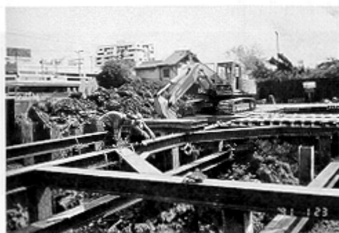
รูปที่ 2 การขุดดินที่ใช้ sheet pile สำหรับฐานรากขนาดใหญ่
