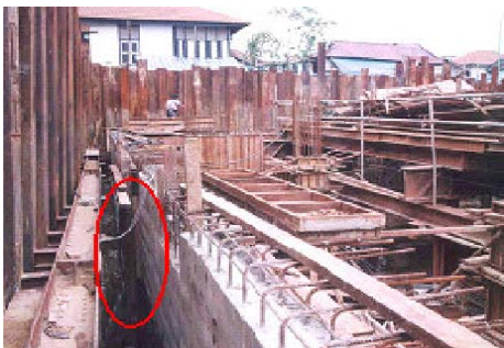
รูปที่ 1. แสดงการถอดค้ำยันออกก่อนที่จะถล่มทรลง [3]
