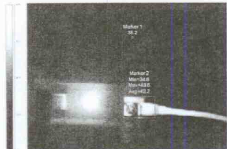
รูปที่ 7 Miniature Circuit Breaker ภายในตู้จ่ายไฟฟ้าย่อยระดับแรงดันไฟฟ้า 415/230 โวลต์
