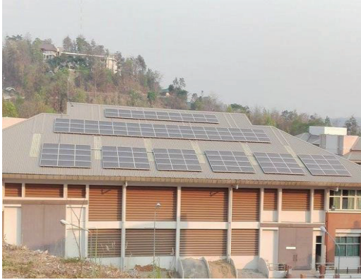
รูปที่ 5 ระบบโฟโตโวลตาอิกติดตั้งบนหลังคา
