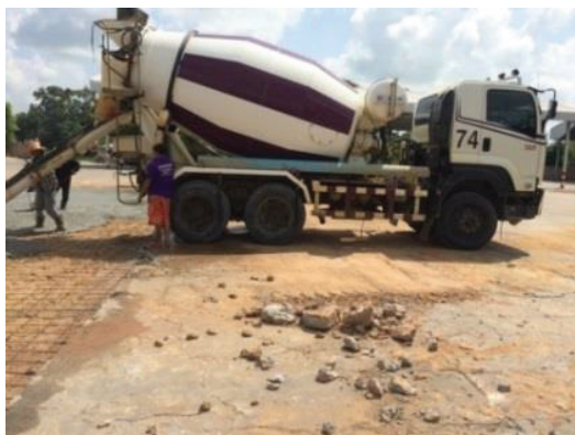
รูปที่ 1 รถคอนกรีตผสมเสร็จเทคอนกรีตผสมเสร็จหน้าโครงการก่อสร้าง
