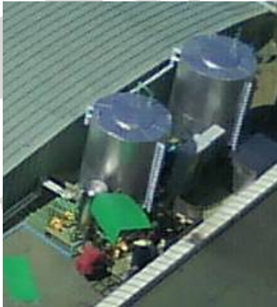
รูปที่ 21 ระบบทำน้ำร้อนแบบปั๊มความร้อนเสริมแสงอาทิตย์ ที่มีการติดตั้งใช้งานที่โรงพยาบาลมหาราชนครเชียงใหม่
